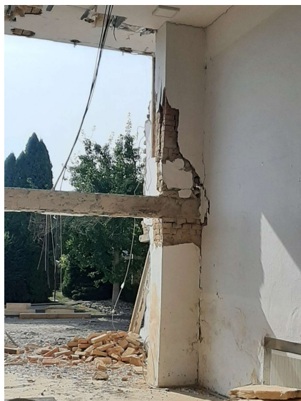
Obr. 63 Silně narušený komínový pilíř. Doposud nebouraný. Zůstala vazba mezi stěnami z ocelového nosníku – doporučeno nyní nebourat.
