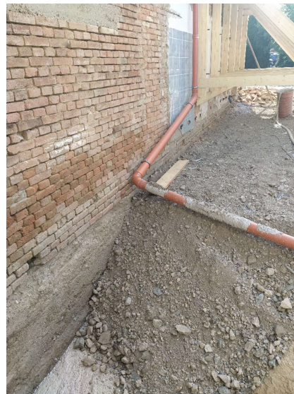
Obr. 70 Pohled na nádvorní stěnu, neprovedený zásyp podélné stěny směrem k podkopaným k základům přístavby hasičské zbrojnice – nutno dosypat
