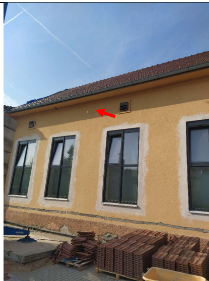
Obr. 60 Trhliny v podélné uliční stěně
