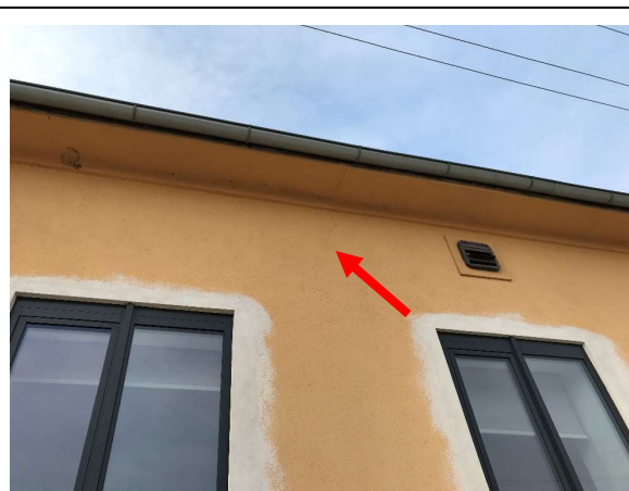
Obr. 20 Trhliny v uliční fasádě
