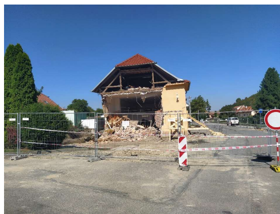
Obr. 56 Zabezpečení místa havárie, plot
