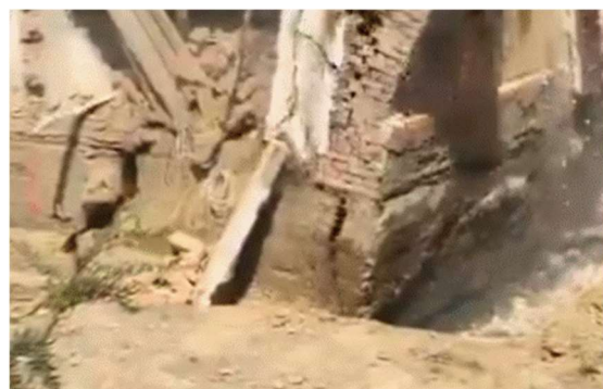
Obr. 34 Snímky z videa [6], detaily rohu odkrytého základu Obr. 28 a Obr. 32
