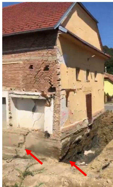
Obr. 28 Snímky z videa [6]. Pokles rohu základu, vyklonění zdiva v úrovni stropu galerie.
