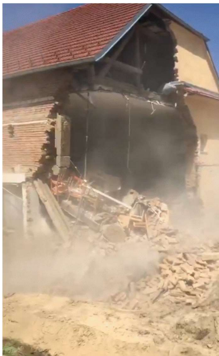
Obr. 33 Snímky z videa [6]. Celková destrukce stropu galerie a štítového zdiva.
