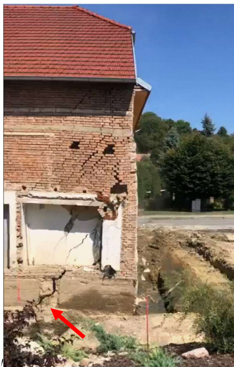
Obr. 27 Snímky z videa [6], rozsah provedeného výkopu, narušení základu. Pokles rohu základu, jeho natočení. Naklonění štítové stěny.
