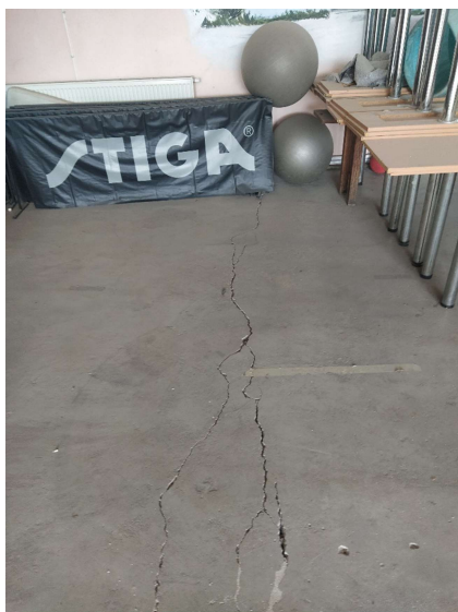
Obr. 65 Trhliny v podlaze podia (strop nad suterénem)
