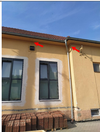
Obr. 59 Trhliny v podélné uliční stěně u ventilátoru a v místě rohu, u římsy
