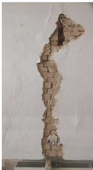
Obr. 51 Detaily poruchy na podélné nádvorní stěně (cca uprostřed délky stěny). Nevhodná vazba cihel, pravděpodobně dodatečně zazděný otvor. Malta se drobí, pevnost nula.
