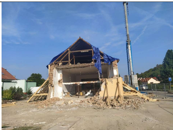
Obr. 57 Pohled na dočasné zajištění místa havárie
