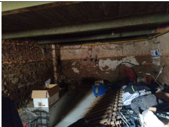
Obr. 61 Sklepní prostor pod pódiem, přístup z hasičské zbrojnice. Viditelné plynové potrubí.
