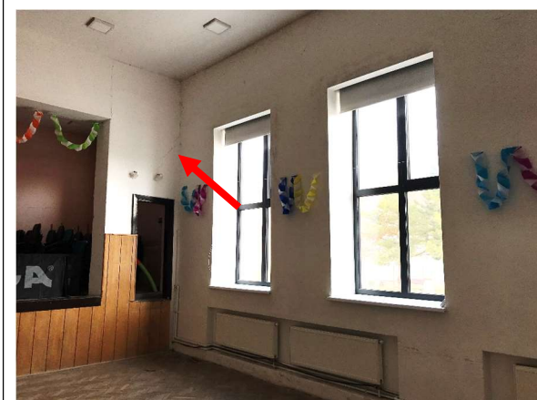
Obr. 23 Trhliny v příčné stěně u jeviště
