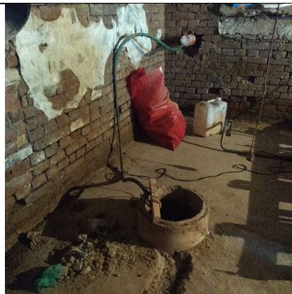
Obr. 62 Suterénní zdivo – viditelné vyboulení zdiva. Zdivo je vhlké, základové půda rozbředlá.
