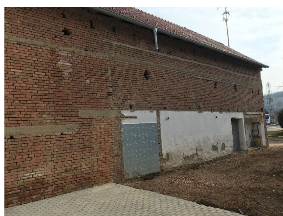
Obr. 22 Nádvorní fasáda – otvory ve zdivu, nevyplněné spáry zdiva
