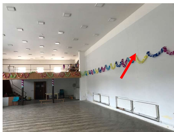
Obr. 24 Trhlina v nádvorní stěně - červená šipka
