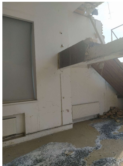
Obr. 64 Pohled zevnitř na zbytky schodiště na galerii
