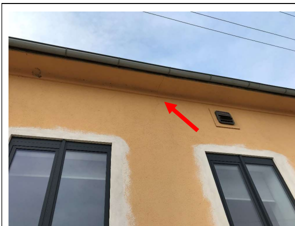
Obr. 19 Trhliny v uliční fasádě
