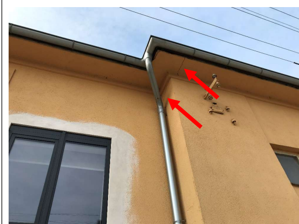
Obr. 21 Trhliny v uliční fasádě
