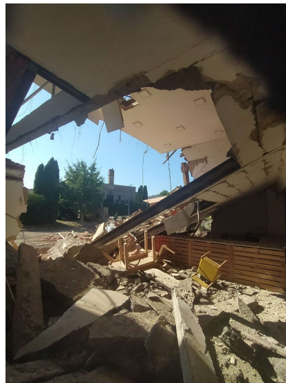
Obr. 52 Pohled na zřícenou galerii zevnitř. Zřícené ocelové nosníky a PZD desky.
